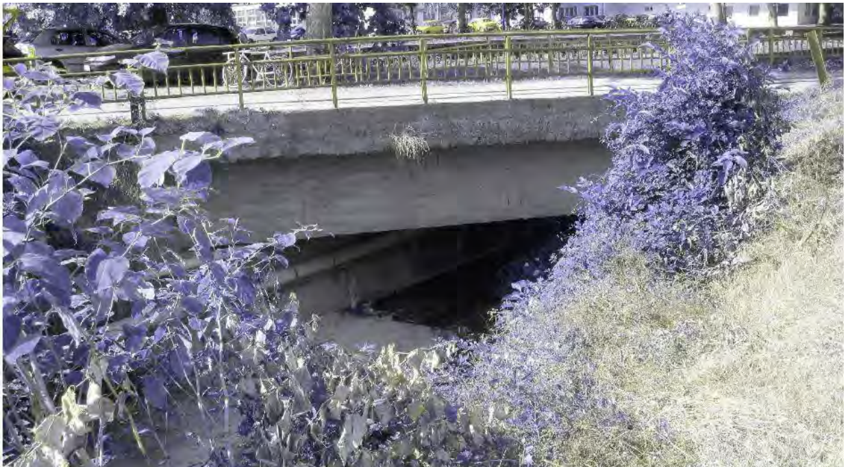
Слика 9. Јездинска Лупњача, пропуст ID:RPMLu5 (недовољан протицајни профил мостовског пропуста)
