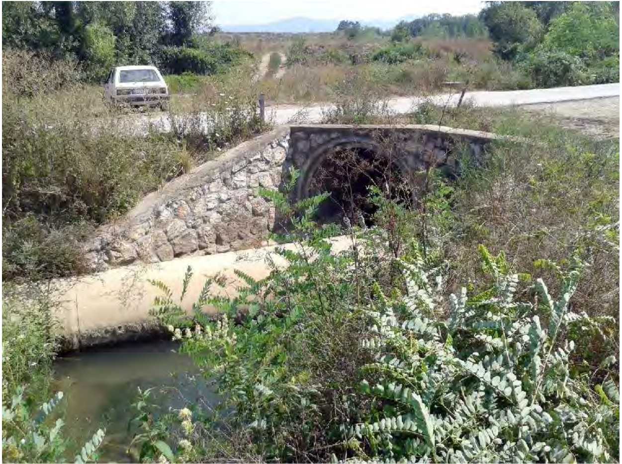
Слика 11. Атеничка река ID:RPMAt1 (Канализациони колектор који се налази у кориту водотока , заједно са пропустом недовољног пречника. Најнизводнији пропуст)
