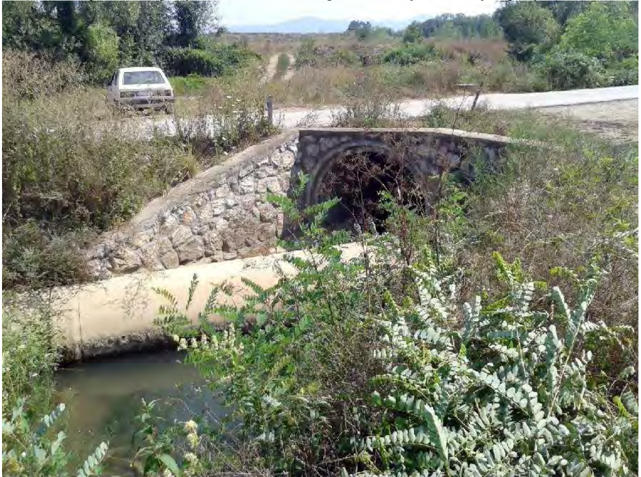
Слика 11. Атеничка река ID:RPMAt1 (Канализациони колектор који се налази у кориту водотока , заједно са пропустом недовољног пречника. Најнизовднији пропуст)
